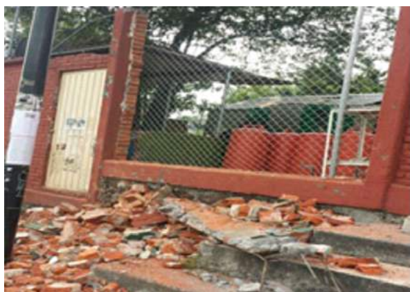
Barda perimetral caída (derecha)
