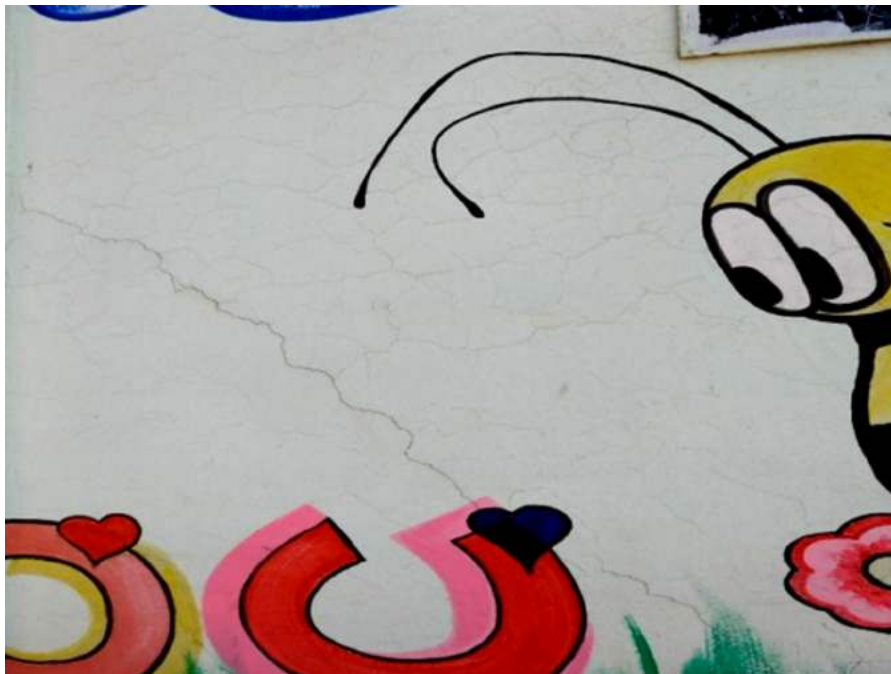
Imagen de la barda perimetral que sufrió daños en el Jardín de Niños Profesor Juan Rosas Talaveras.
