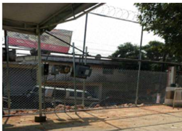
Barda perimetral caída (izquierda)
