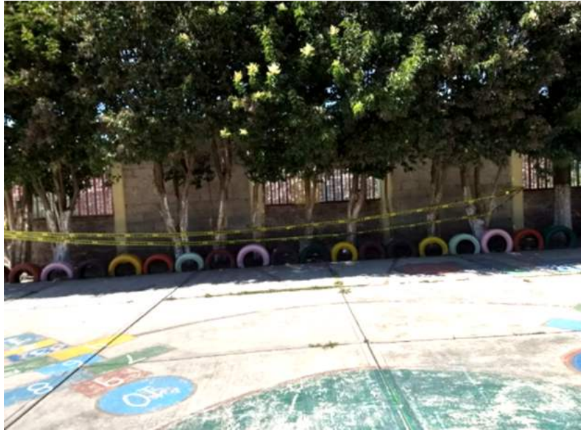
Barda perimetral peligrosa.
